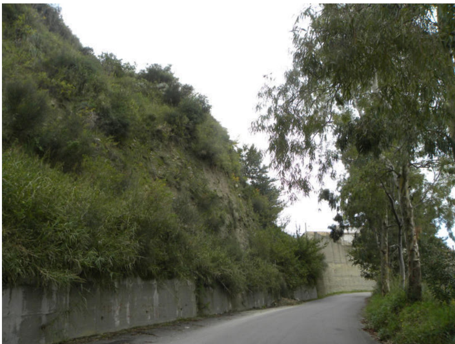
(foto sopra - particolare Intervento Km. 8 + 000 circa c/da Scalone-Torrione: Conglomerati in matrice sostenuti)
