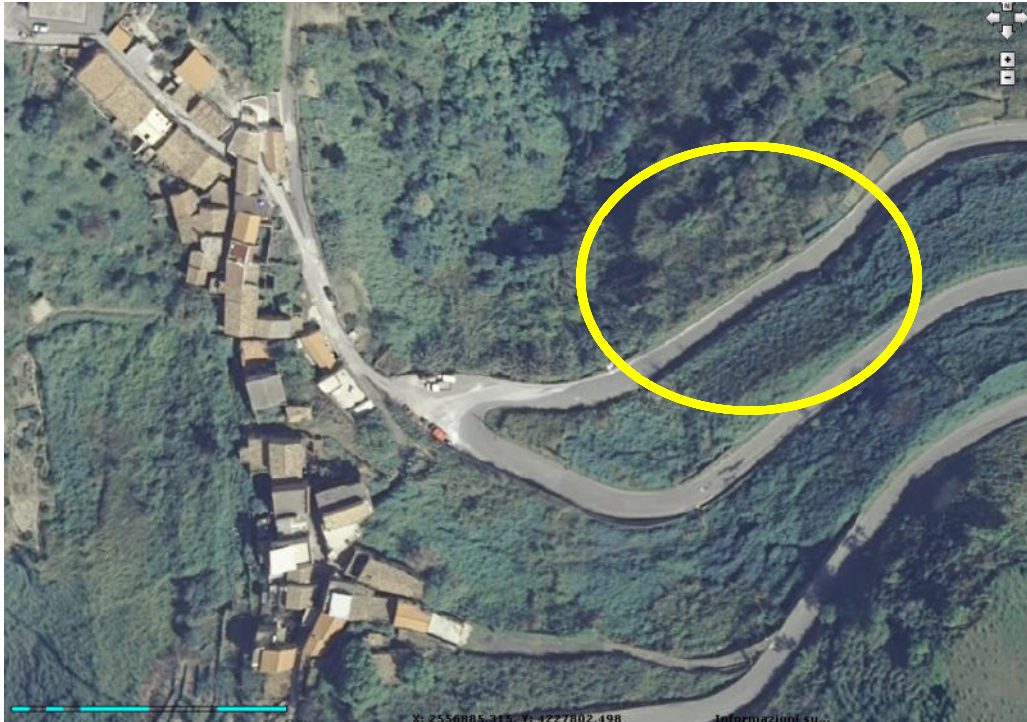
SP 54 bis Km. 5 + 250 circa c/da Rapano – area localizzazione indagini geognostiche. foto sotto: Carreggiata ristretta con argine in conglomerato bituminoso per cedimento scarpata.
